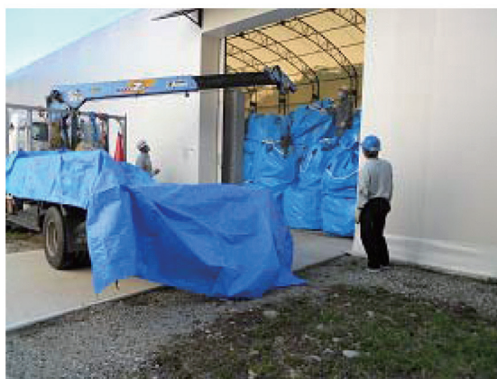
図19 高濃度汚染飛灰の保管用テント(焼却施設内)
